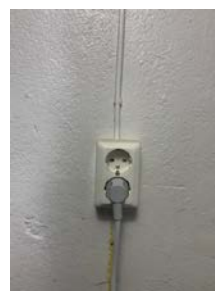
Stikkontakt tilkobling er ikke forskriftsmessig
