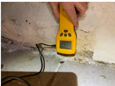
Høye fuktsøkverdier nederst på vegger
