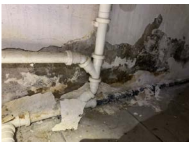
Synlig puss og malingsavflassing
