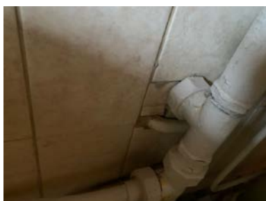
Rørgjennomføring uten mansjett
