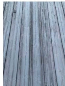
Aldersrelatert slitasje og etterslep av vedlikehold
