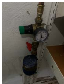
Nyere stoppekran. Fungerer som tiltenkt.
