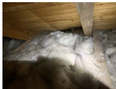
Isolasjon ført helt mot undertak. Ingen synlig lufting av konstruksjonen
