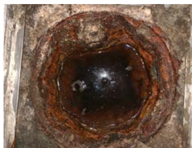
Originalt sluk. Synlig rustdannelse
