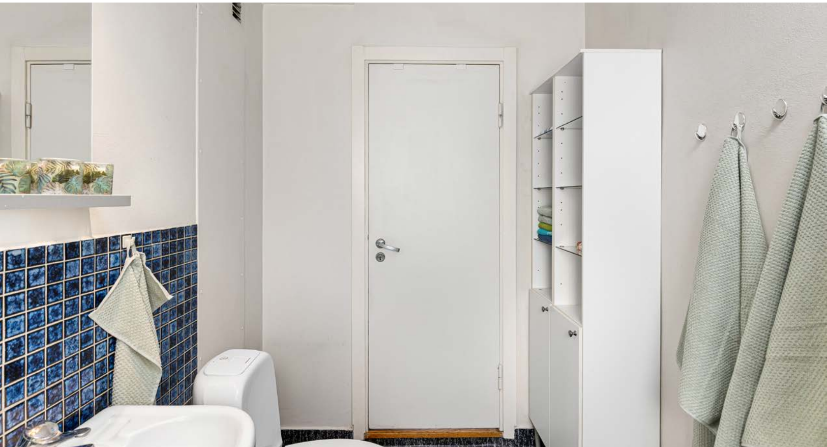
Baderommet er av eldre dato og trenger modernisering
