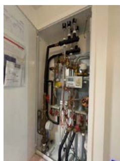
Fordeler skap for fjernvarme/vannrør
