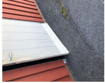
Dør som subber mot terreng
