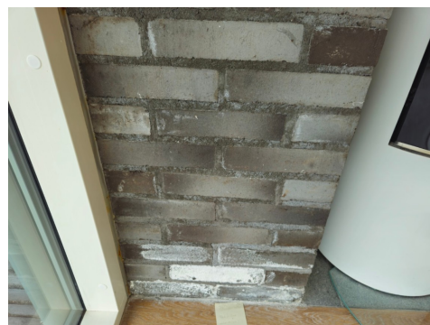
Saltutslag på teglsteinpipe
