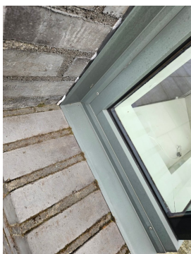
Lekkasje ved vindu. Vann trenger inn i konstruksjon
