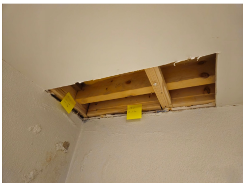
Det er påvist fuktighet i bjelkelag
