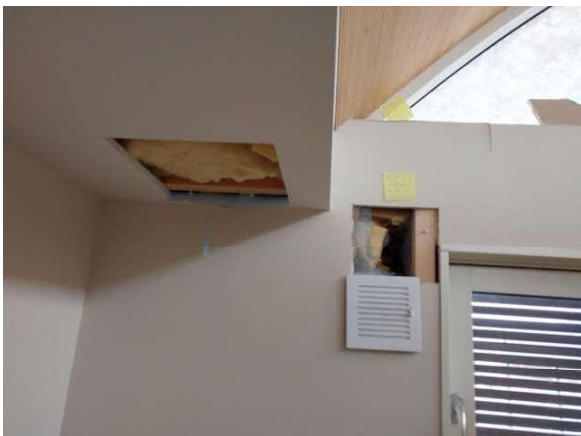
Gips åpnet for å avdekke fukt skader i innkassing og yttervegg.
