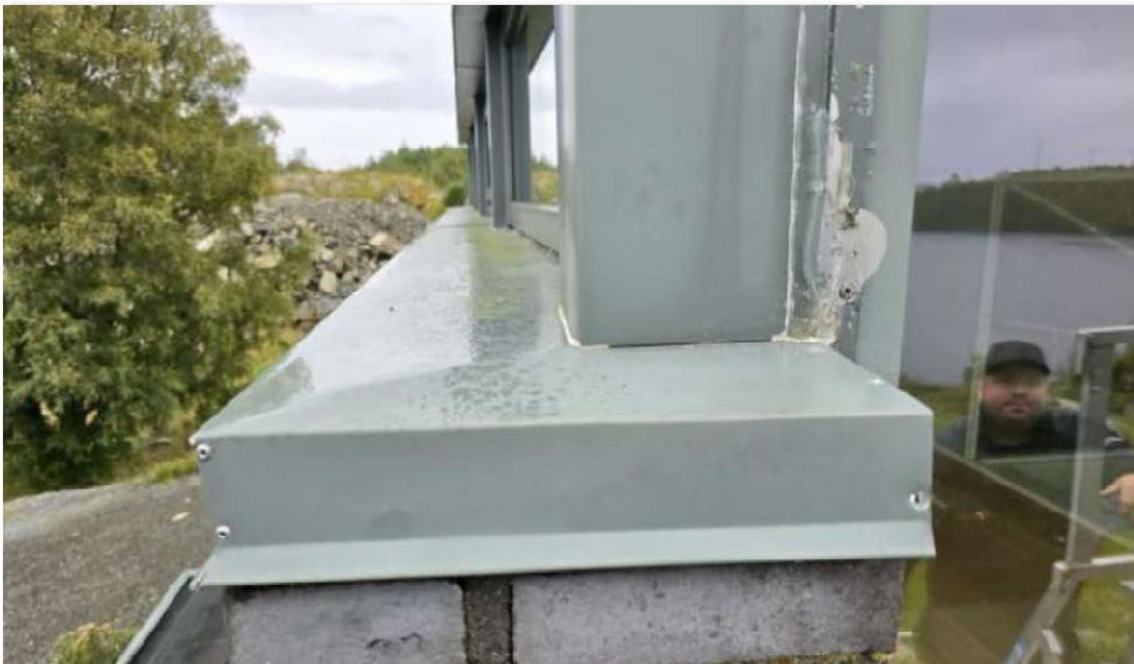
Bilde 4 – viser beslaget under vinduet på øst. Beslaget har fall og vannet ledes ut over fasaden. Bildet er hentet fra rapporten til Taksthuset Vest.
