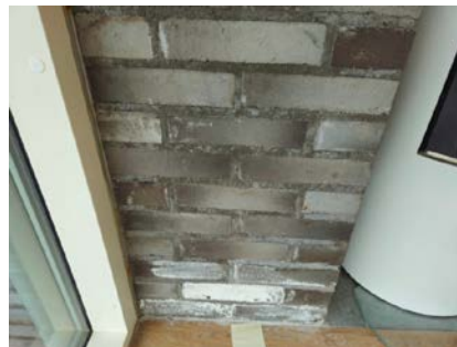
Saltutslag på teglsteinpipe
