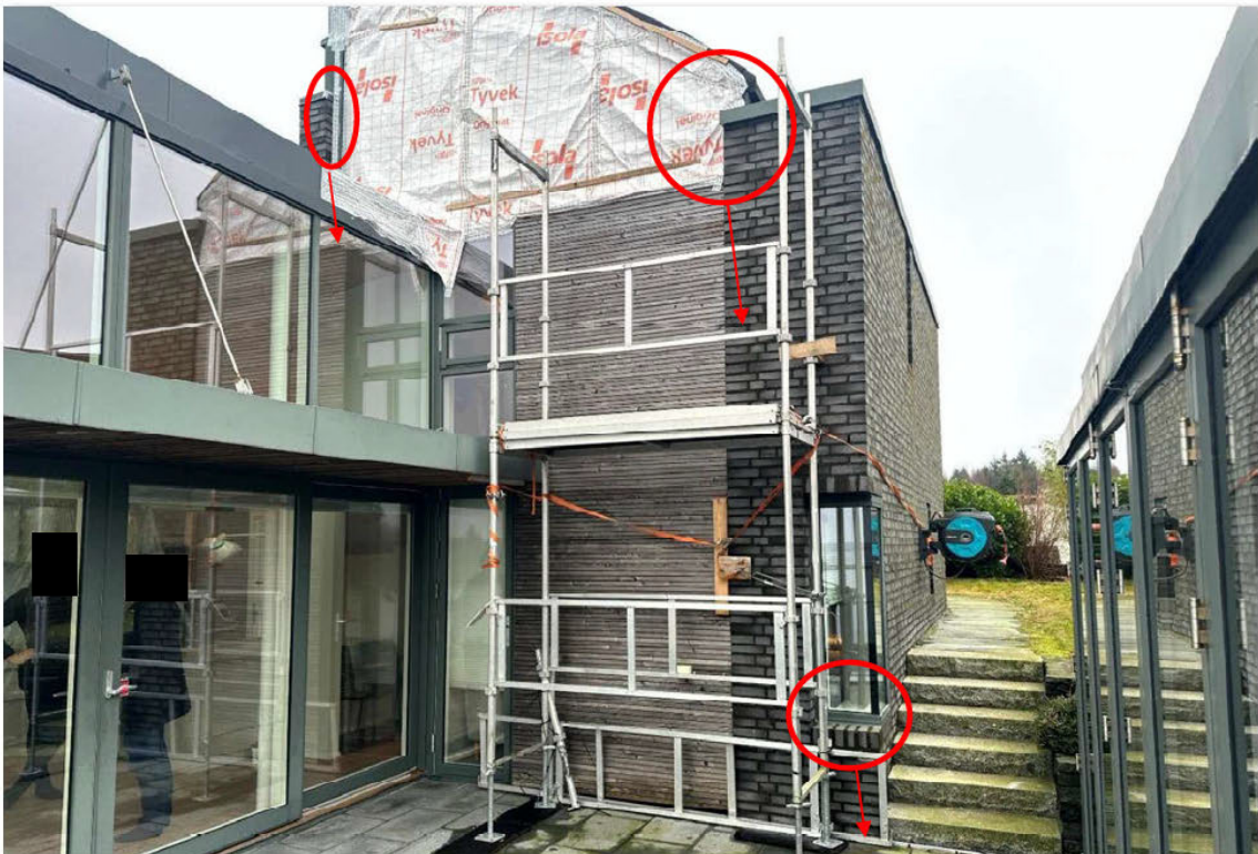
Bilde 7 – viser fasaden mot vest, med markerte lekkasjepunkter. Bak teglfasaden er det avdekket skader i konstruksjonen. Fasaden må rives for å utbedre skadene på konstruksjonen.
