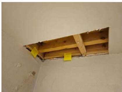
Det er påvist fuktighet i bjelkelag
