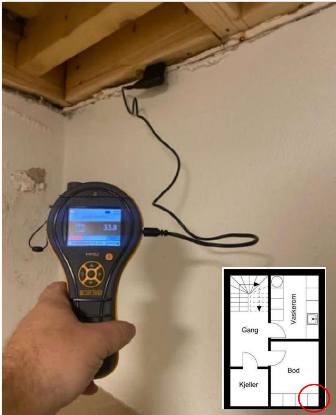
Bilde 8 – viser forhøyede fuktverdier i kjellerboden. Bildet er hentet fra rapporten til Taksthuset Vest.
