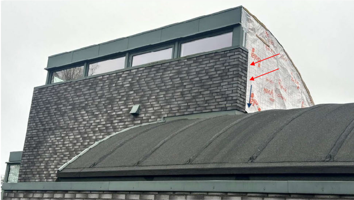
Bilde 3 – viser fasaden mot øst og vest, hvor lekkasjepunktet ned mot underliggende stue er i overgangen mellom glassfasade og tegl i markert område. Det er ikke avdekket skader på konstruksjonen bak tegl fasaden.
