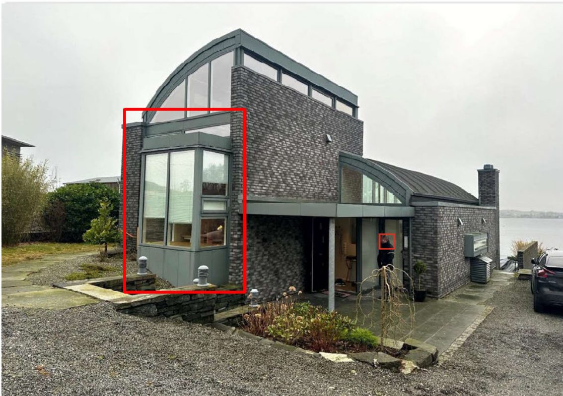
Bilde 2 – viser fasaden mot nord-øst. Det er ikke avdekket skader på konstruksjonen som krever riving av tegl fasade. Det er avdekket feil utførelse ved beslagsarbeidene ved trapperommet, dette bør utbedres.
