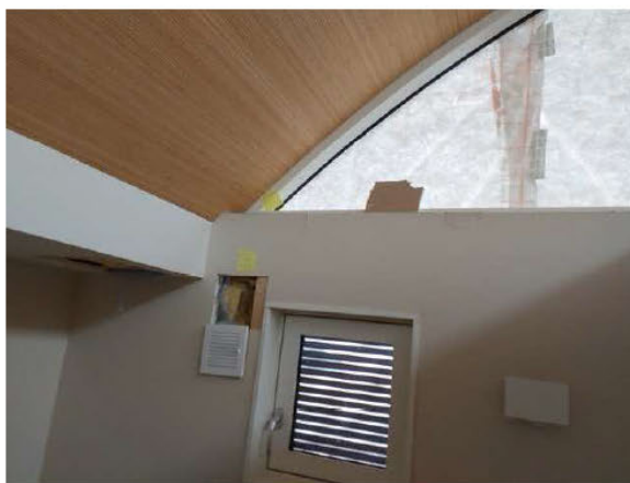
Gips åpnet for å avdekke fukt skader i innkassing og yttervegg.
