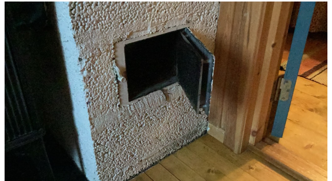
Viser sotluke i gang med avstand < 30 cm fra brennbart (gulv og dør).
