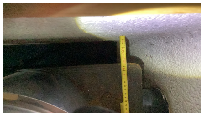
Viser avstand < 10 cm fra vedovn til brannmur i gang.
