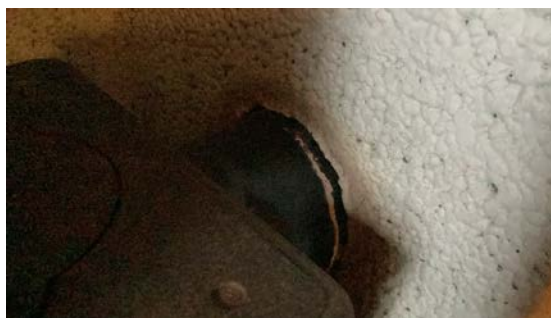
Viser manglende røykrørsinnføring i pipe i gang.
