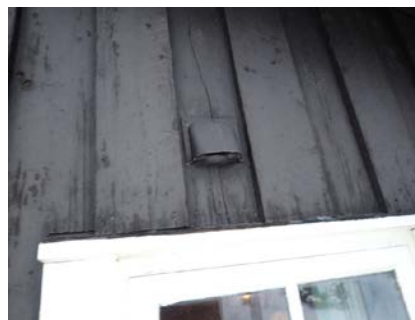
Viser noe tørr og oppsprekt kledning
