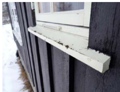
Viser vannbrett preget av elde/værslitasje.
