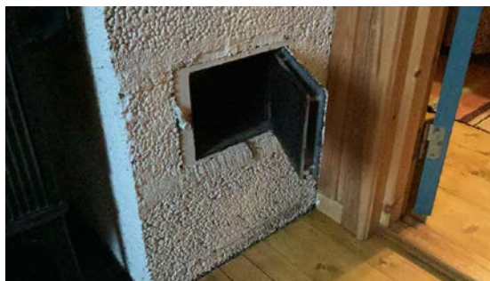
Viser sotluke i gang med avstand < 30 cm fra brennbart (gulv og dør).
