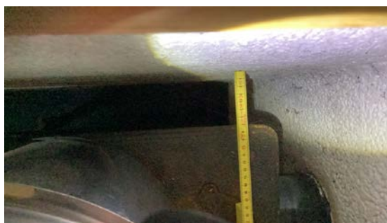
Viser avstand < 10 cm fra vedovn til brannmur i gang.
