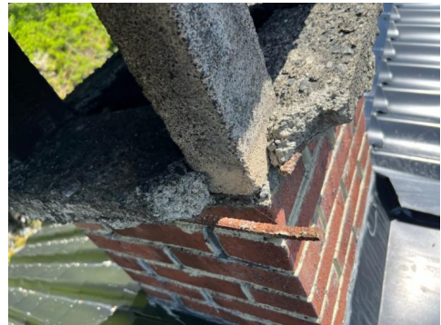
Slitasje på pipe/krans over tak
