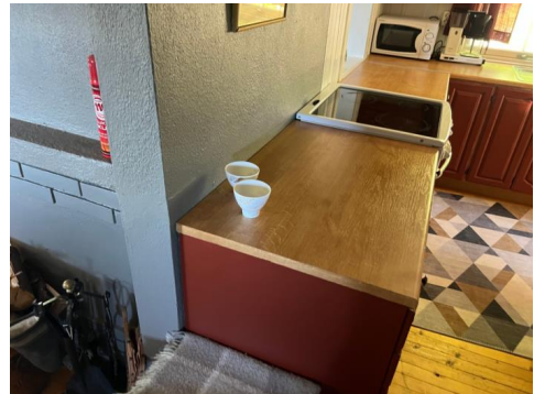
Innredning/brennbart materiale er beliggende inntil skorstein
