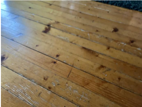
Slitasje på gulvoverflate.
