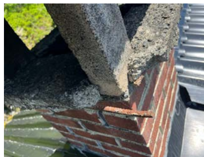
Slitasje på pipe/krans over tak
