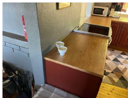
Innredning/brennbart materiale er beliggende inntil skorstein
