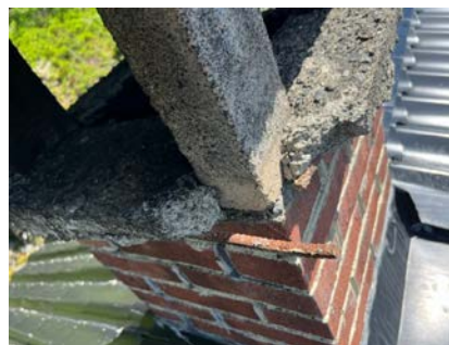
Slitasje på pipe/krans over tak
