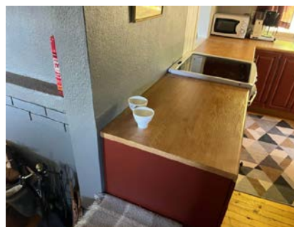
Innredning/brennbart materiale er beliggende inntil skorstein
