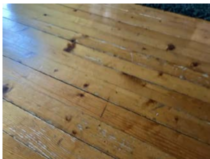
Slitasje på gulvoverflate.
