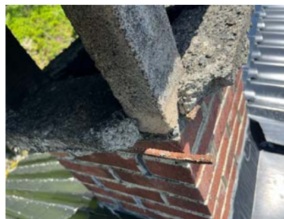
Slitasje på pipe/krans over tak
