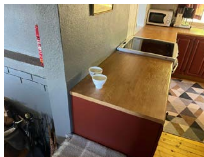
Innredning/brennbart materiale er beliggende inntil skorstein
