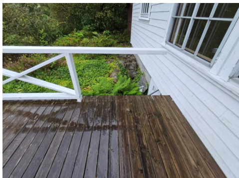
Det mangler deler av rekkverk.
