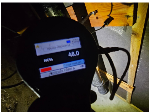
Det er påvist høy fuktighet i trevirke i krypkjeller.
