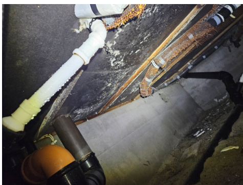
Krypkjelleren har kondensutfordringer.
