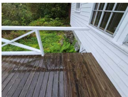
Det mangler deler av rekkverk.
