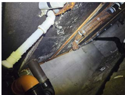
Krypkjelleren har kondensutfordringer.
