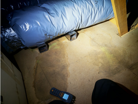
Nevnte fukt skjold som eier oppsto ved montering av takhatt.
