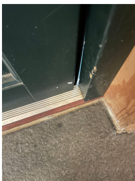
Synlig lysåpning mellom karm og pakning.
