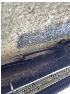
Manglende lufting på kledning fra byggeår
