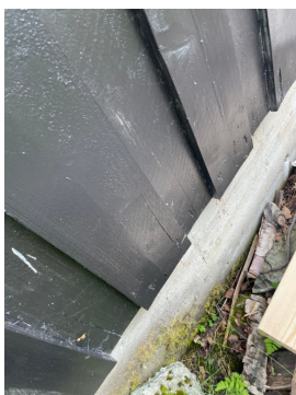
Eksempel på værslitt/oppsprukket trekledning.
