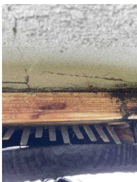
Lufting er ok på tilbygg fra 2011.
