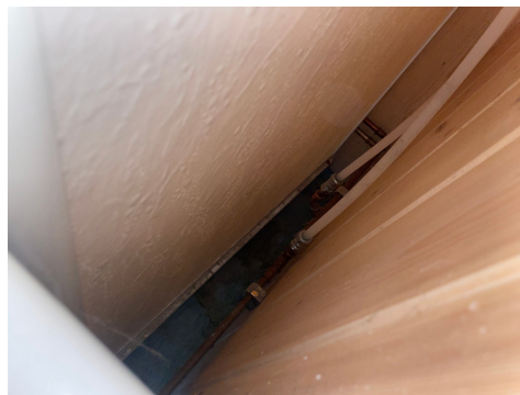
Trepanel på vegg bak dusjkabinett.
