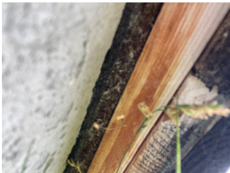
Manglende lufting på tilbygg fra 2002
