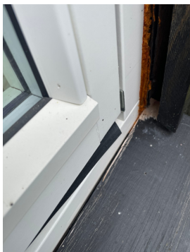
Ufaglig avslutning på vannbrett.
