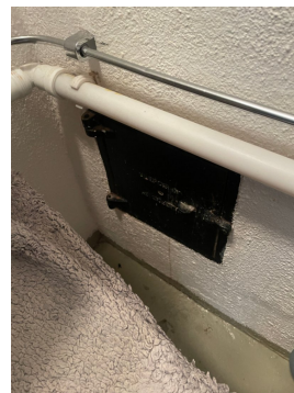
Avløpsrør ligger for nærmere sotluke.
