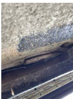
Manglende lufting på kledning fra byggeår
