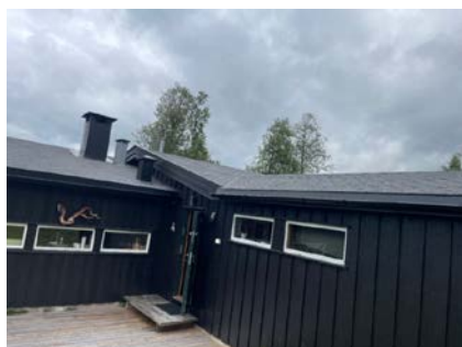
Stedvis synlig mose og slitasje.
