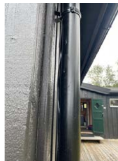
Eksempel på frostsprengt nedløp.
