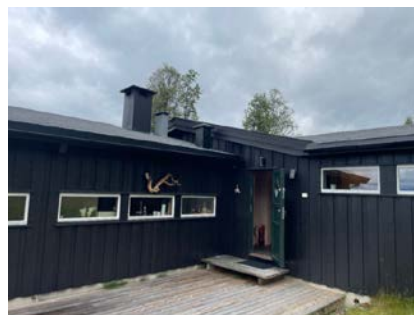
Mangler stigetrinn til pipe.
