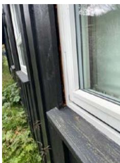
Ufaglig avslutning overgang yttervegg/vinduskarm
