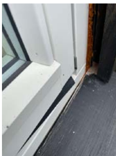
Ufaglig avslutning på vannbrett.
