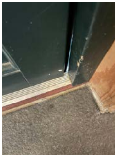
Synlig lysåpning mellom karm og pakning.
