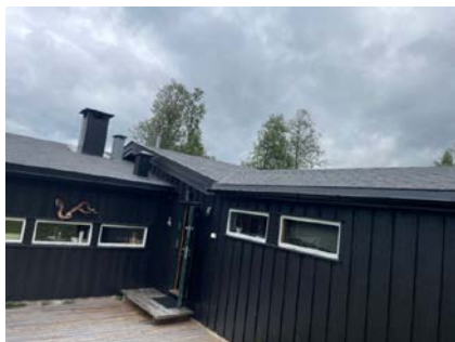
Stedvis synlig mose og slitasje.
