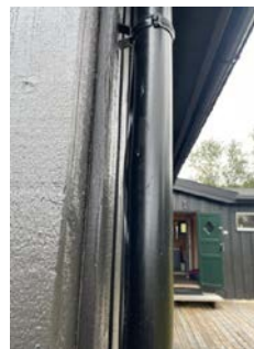
Eksempel på frostsprengt nedløp.
