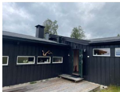
Mangler stigetrinn til pipe.
