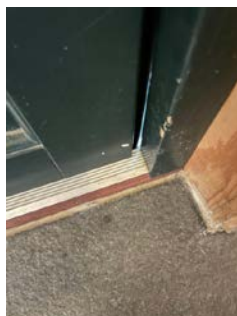
Synlig lysåpning mellom karm og pakning.
