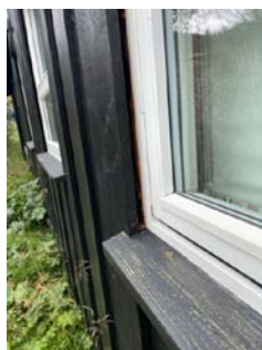
Ufaglig avslutning overgang yttervegg/vinduskarmer
