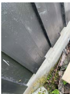
Eksempel på værslitt/oppsprukket trekledning.
