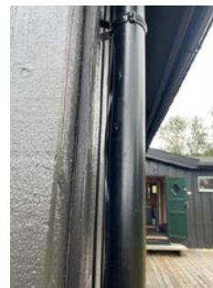
Eksempel på frostsprengt nedløp.
