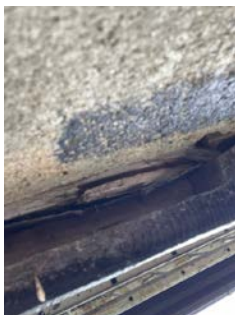
Manglende lufting på kledning fra byggeår
