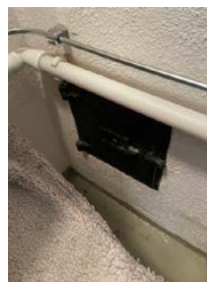
Avløpsrør ligger for nærme sotluke.
