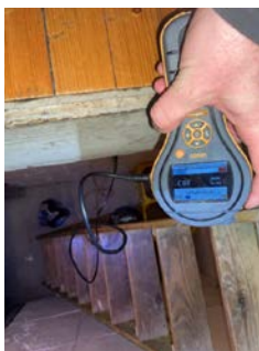
Det måles høy fuktighet i treverk med fare for ytterligere skadeutvikling.
