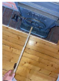
Ildfast plate mangler foran ilegg på vedovn
