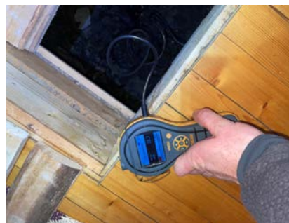
Det måles høyt fuktnivå i treverk med fare for ytterligere skadepotensiale.
