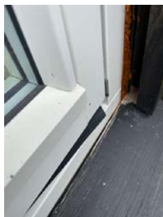
Ufaglig avslutning på vannbrett.
