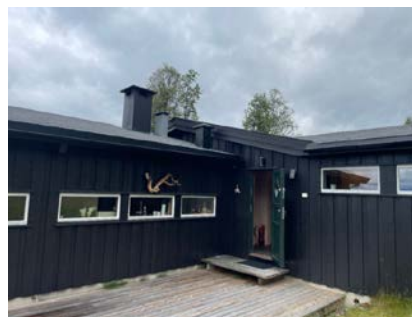
Mangler stigetrinn til pipe.
