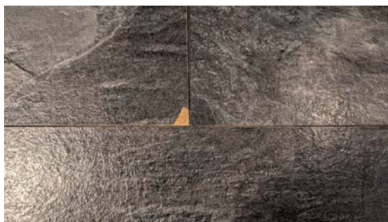
Eksempel på bruksmerke og mindre skader.
