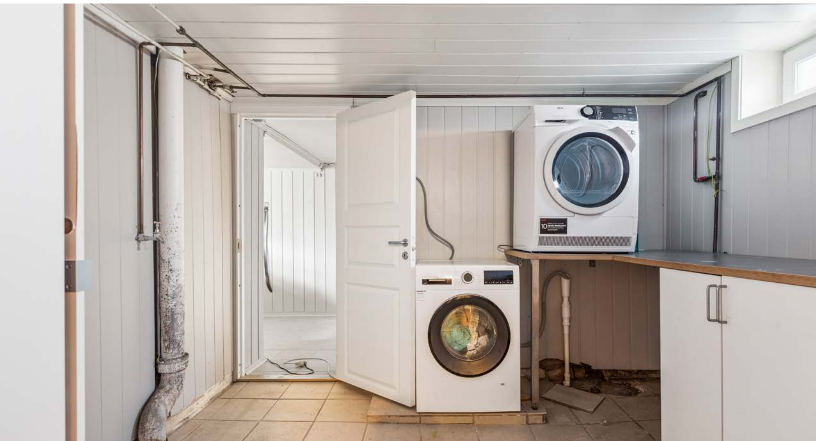
Vaskerom i underetasje.
