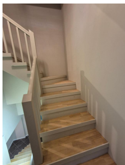
Trapp til 2. etg. mangler håndløper mot vegg.
