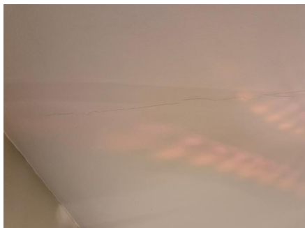
Sprekker i takplater i kjeller.
