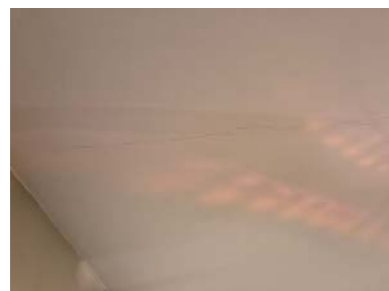
Sprekker i takplater i kjeller.
