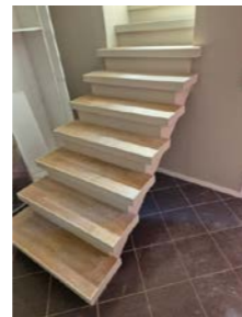
Trapp til kjeller mangler rekkverk.
