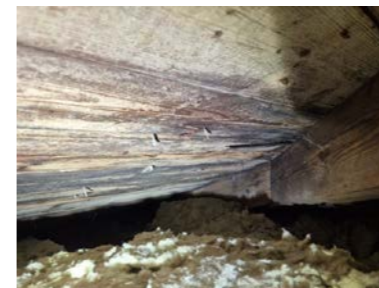
Misfarging av undertak og ikke luft i nedre del av loft.
