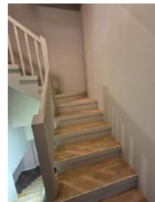
Trapp til 2. etg. mangler håndløper mot vegg.
