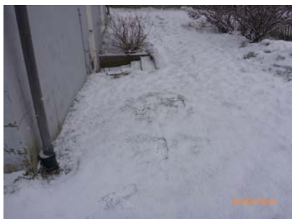
Ikke fall fra bygget i øst.
