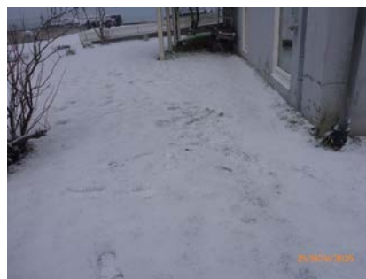
Ikke fall fra bygget i sør
