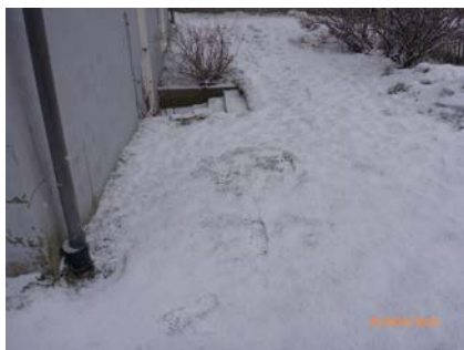
Ikke fall fra bygget i øst.
