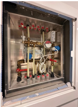
Samleskap på bad med rørkurser og stoppekraner
