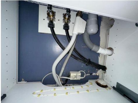
Røropplegg i kjøkkenbenk med Waterguard
