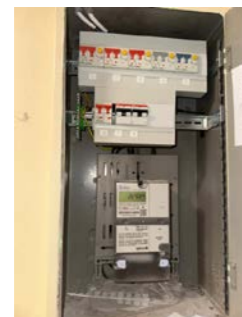
Sikringsskap med automatsikringer.
