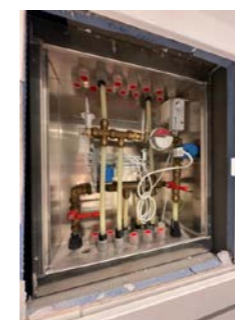
Samleskap på bad med rørkurser og stoppekraner
