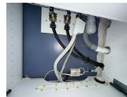
Røropplegg i kjøkkenbenk med Waterguard
