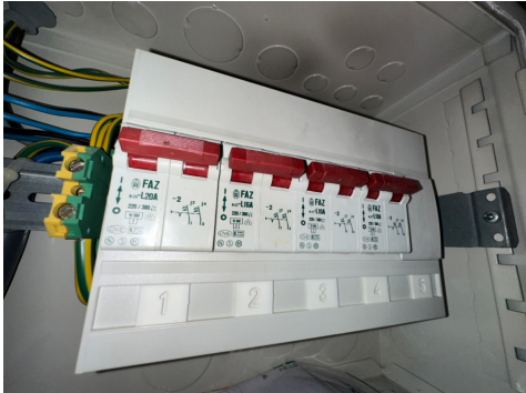
Sikringsskap med automatsikringer.
