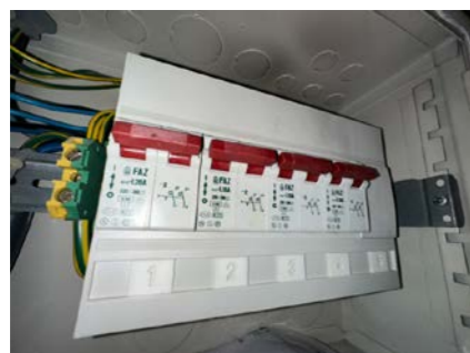
Sikringskap med automatsikringer.
