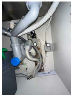
Rørøpplagg i kjøkkenbenk med Waterguard
