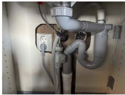
Avløpskoblinger på kjøkken.
