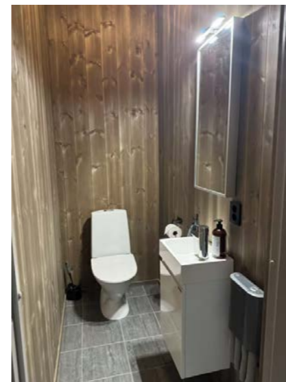
Toalettrom er fungerende.
