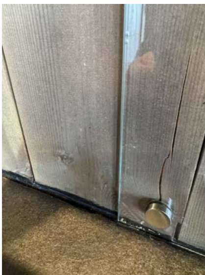
Sprekk i panel på grunn av skrue til glassplate.
