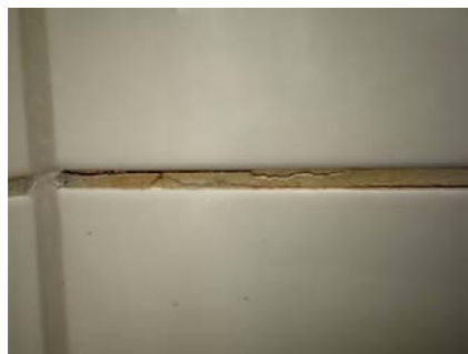
Sprekker i flisfuger på vegg i dusjsone.
