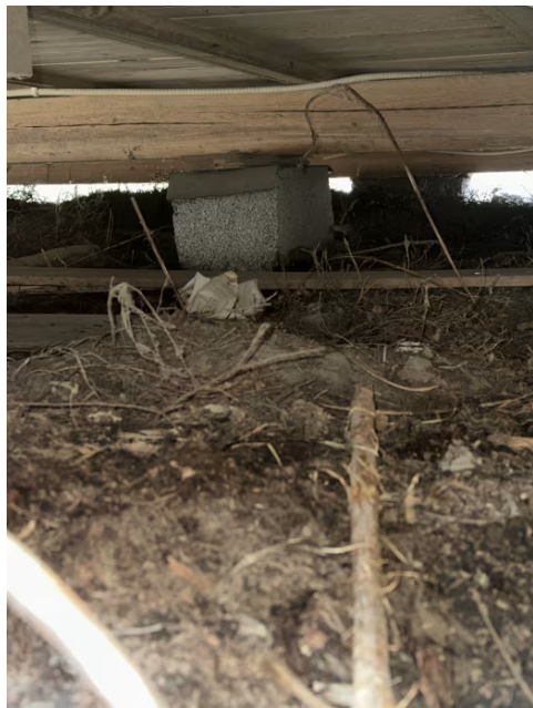
Viser skjevhet ved fundamenter.
