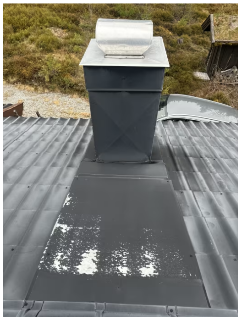
Viser pipebeslag over tak.
