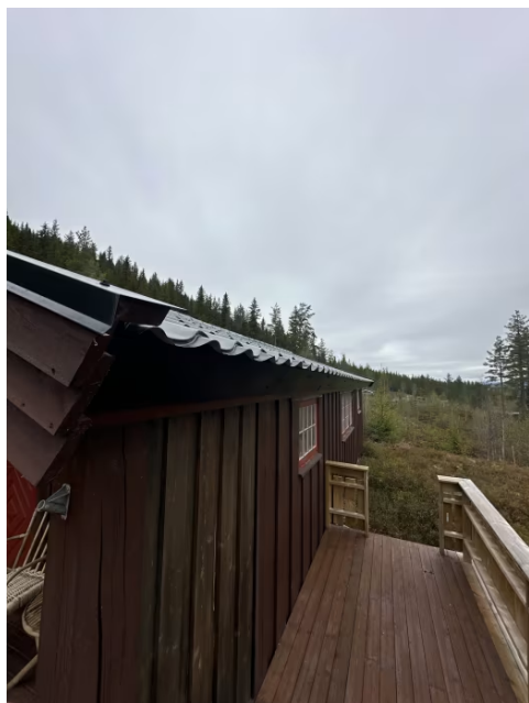
Det er ikke montert noen takrenner.
