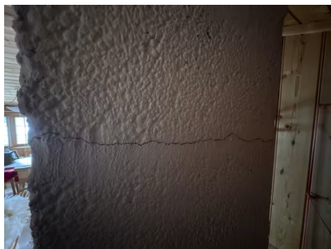
Viser sprekk i pipe.
