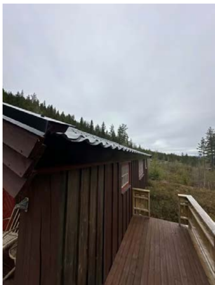
Det er ikke montert noen takrenner.
