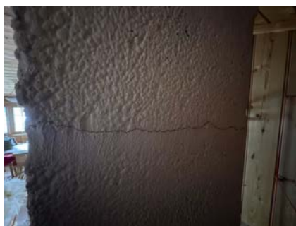
Viser sprekke i pipe.
