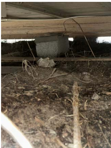
Viser skjevhet ved fundamenter.
