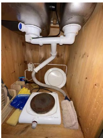
Viser avløpsinnstallasjoner under kum. Avløp ført direkte til terreng.
