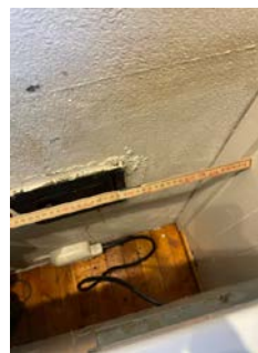
Manglende ubrennbar plate gulv. Avstand til brennbart er for kort.
