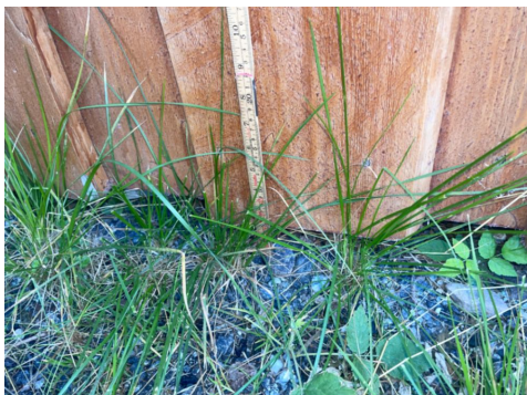
Kledningsbord stedvis ned til terreng
