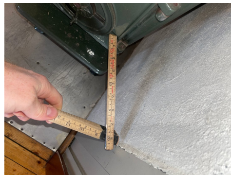
Avvik til brennbar ved illekk under 30 cm
