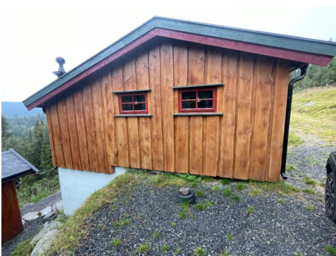
Mangler lufting av lukket konstruksjon.
