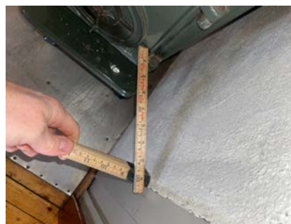
Avvik til brennbar ved ilegg under 30 cm
