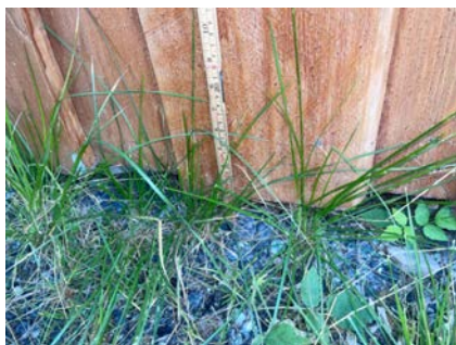
Kledningsbord stedvis ned til terreng
