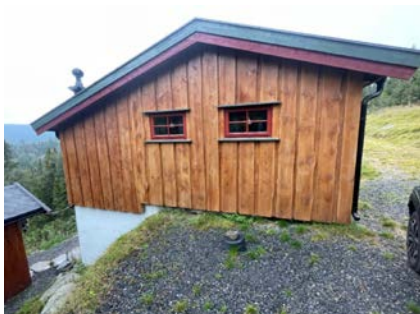
Mangler lufting av lukket konstruksjon.
