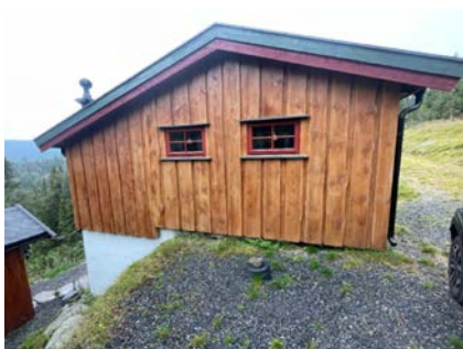
Mangler lufting av lukket konstruksjon.
