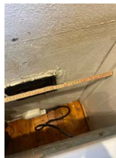
Manglende ubrennbar plate gulv og avstand til brennbar er for liten.
