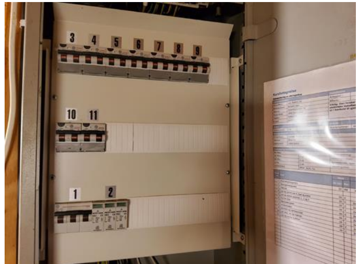
Elektrisk anlegg - [Sikringsskap]
