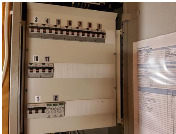
Elektrisk anlegg - [Sikringsskap]
