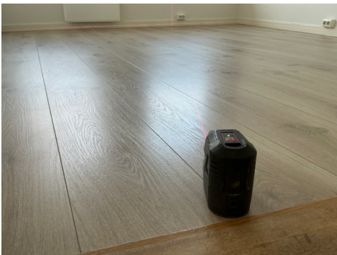
Nivellering soverom, avvik ca. 10-20 mm
