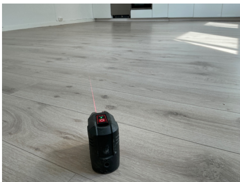
Nivellering stue/kjøkken, avvik ca. 10-20 mm
