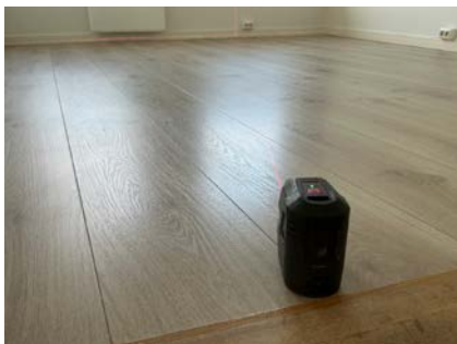
Nivellering soverom, avvik ca. 10-20 mm
