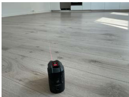
Nivellering stue/kjøkken, avvik ca. 10-20 mm
