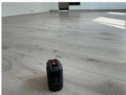
Nivellering stue/kjøkken, avvik ca. 10-20 mm
