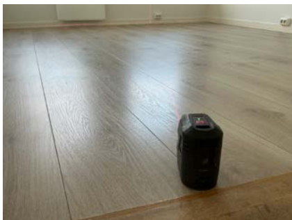
Nivellering soverom, avvik ca. 10-20 mm
