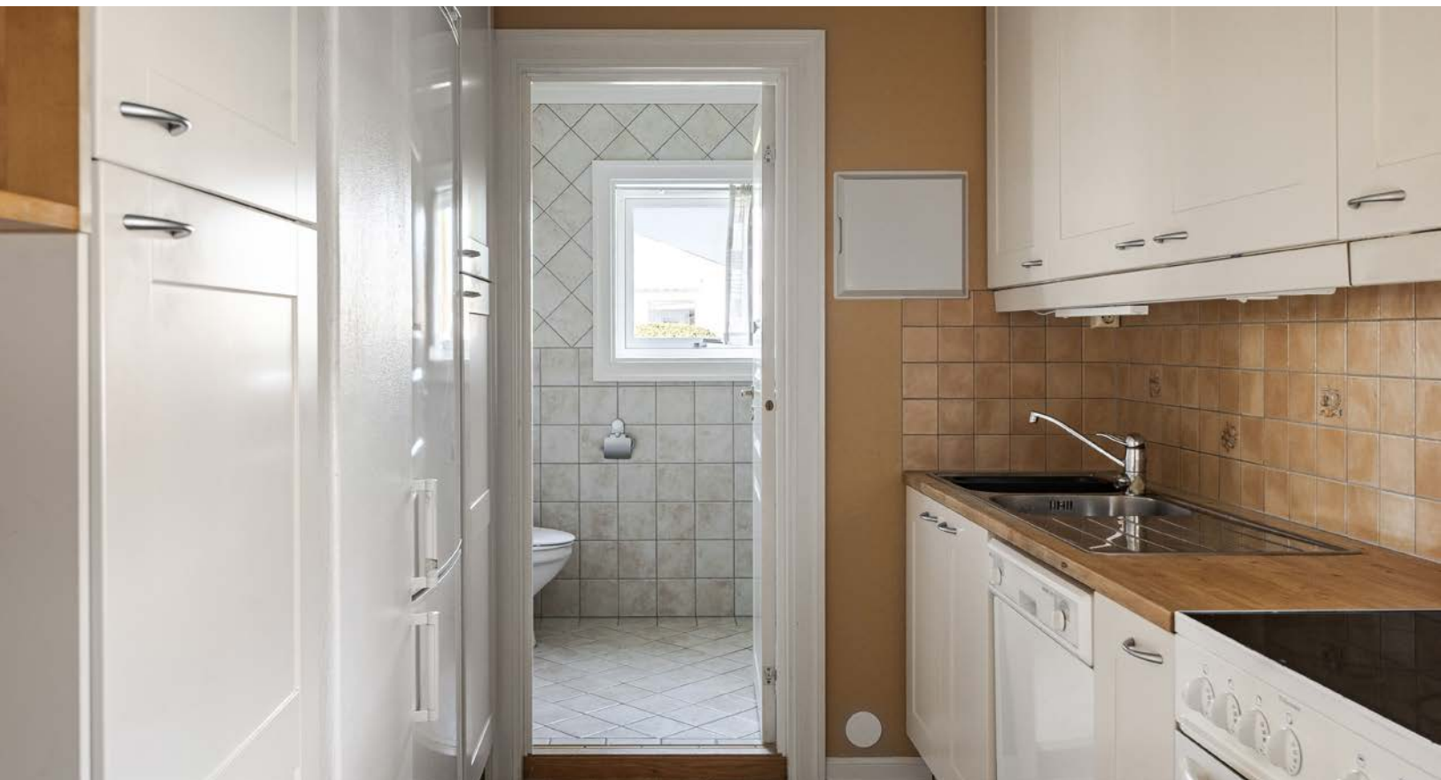
Sikringsskap med automatsikringer, montert på vegg på kjøkken.
