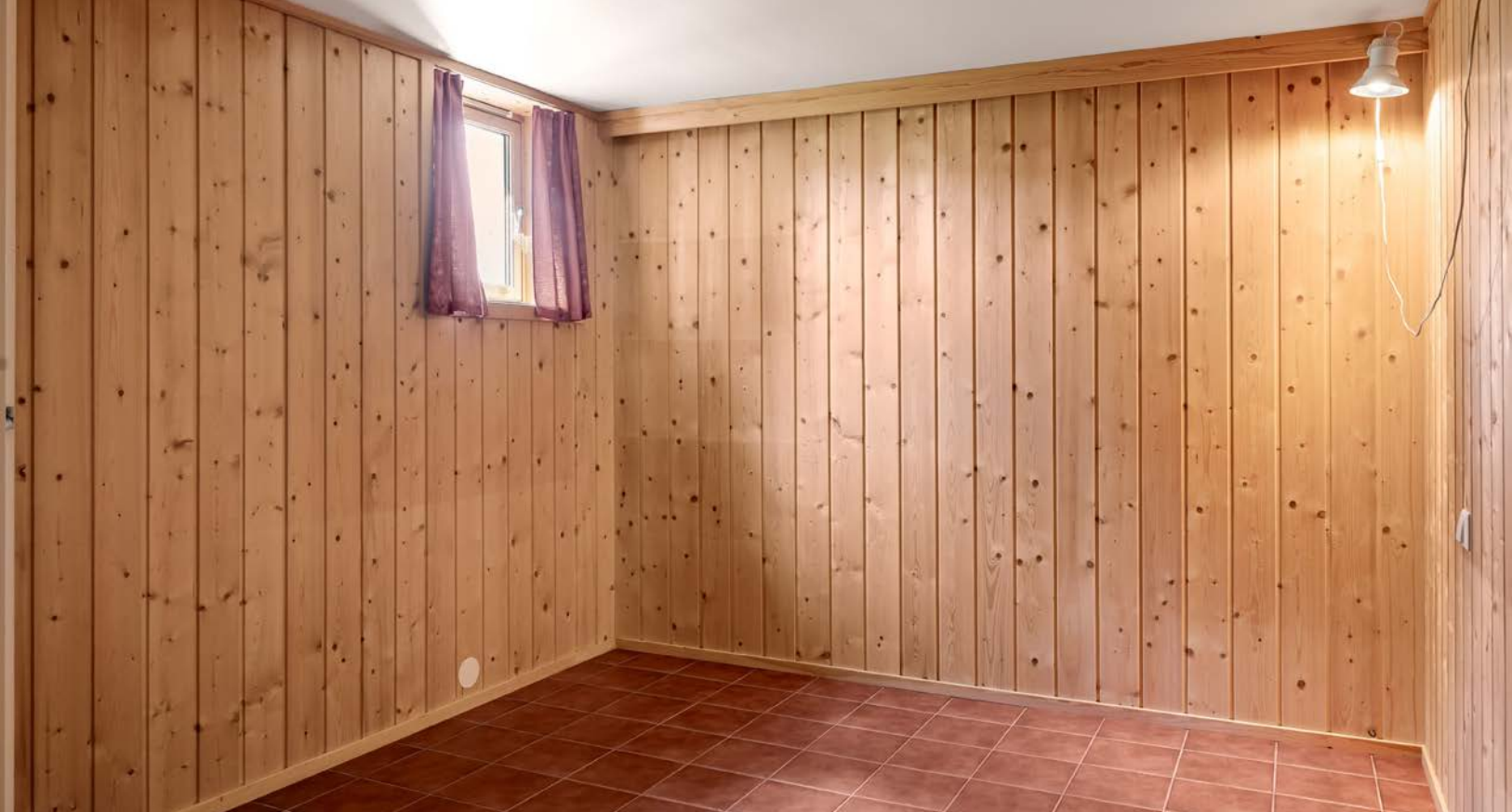
Rom benyttet som soverom 2 i kjeller. Det gjøres oppmerksom på at soverom i kjeller har ikke godkjente rømningsvinduer.
