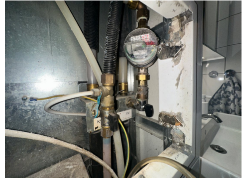
Stoppekraner plassert på bad
