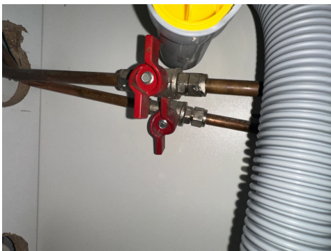
Stoppekraner plassert på kjøkken
