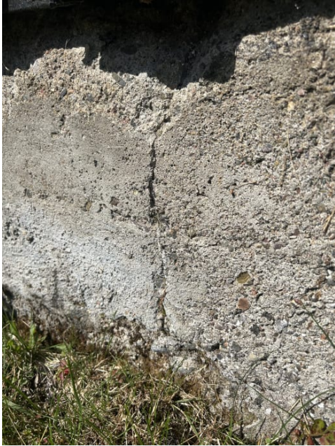
Sprekk i ringmur.
