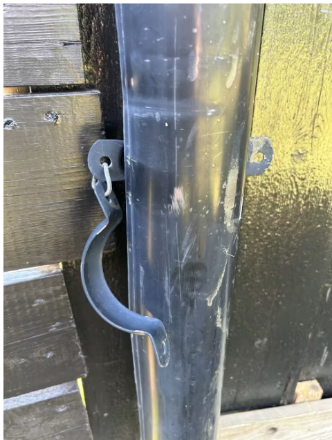
Manglende innfesting på nedløp.
