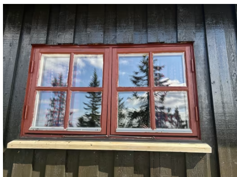
Manglende beslag på vennbrett.
