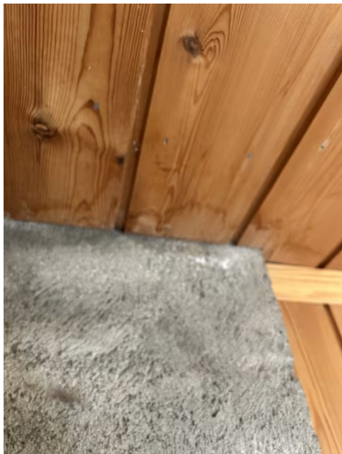
Fuktmerker i tak.
