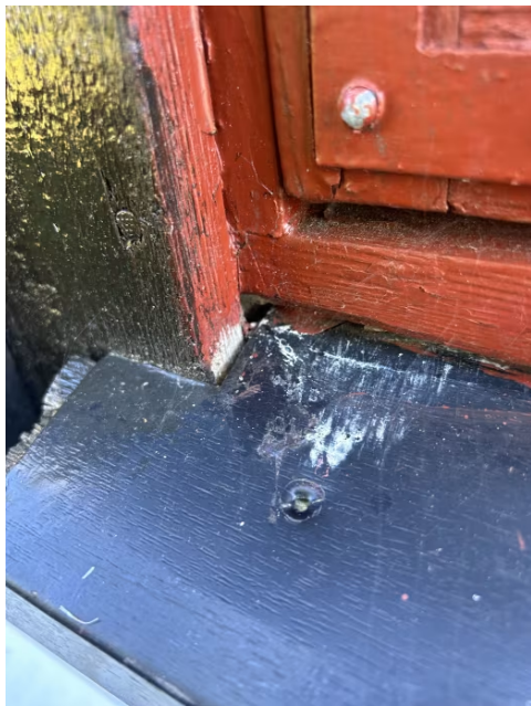
Utett mellom vannbrett og vindu.
