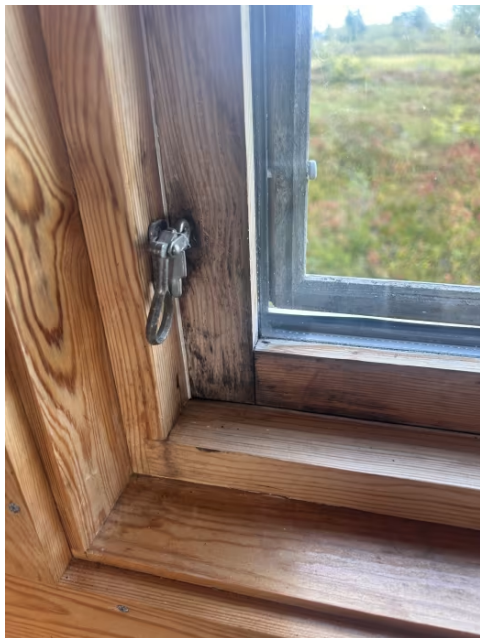
Fuktmerker og svertesopp i vinduskarm.
