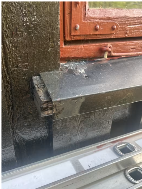
Utett mellom vannbrett og vindu.
