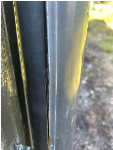
Frostspreng i nedløp.
