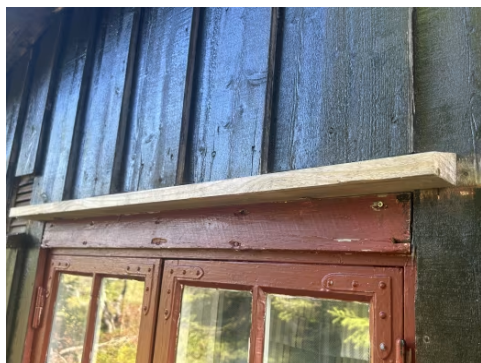
Manglende beslag på vannbrett over vindu.
