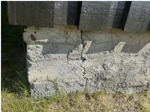
Sprekk i ringmur.
