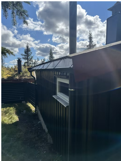
Ujevnheter i takrenne.
