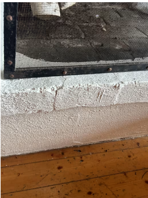
Sprekk i peis.
