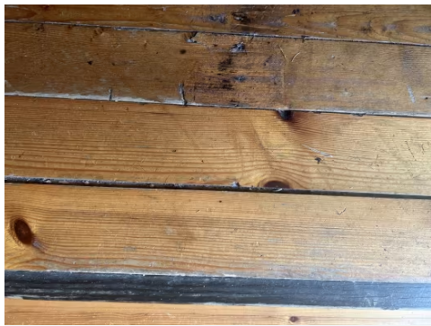
Sprekker i gulv.
