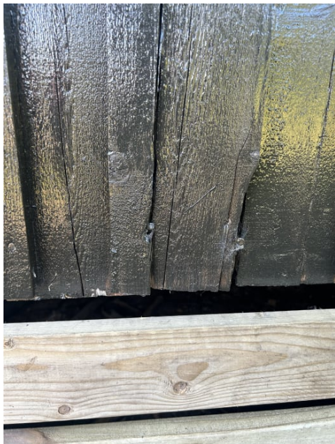
Sprekk i kledning.
