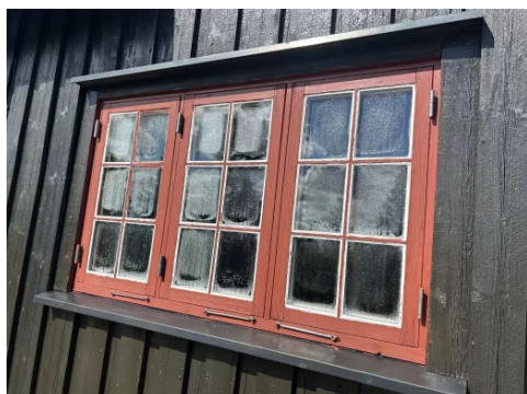
Dugg i mellom vinduer på stue.
