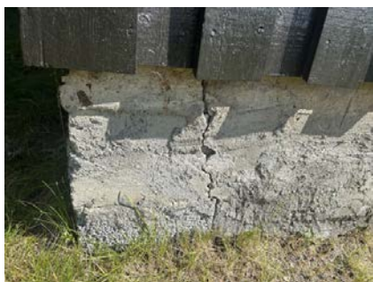
Sprekk i ringmur.
