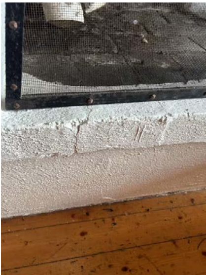
Sprekk i peis.
