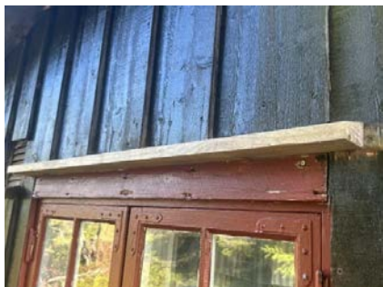
Manglende beslag på vannbrett over vindu.
