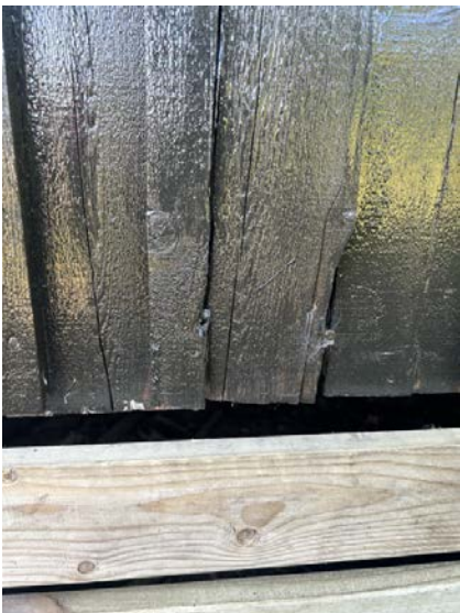
Sprekk i kledning.
