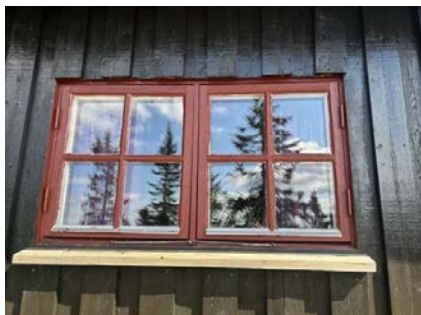
Manglende beslag på vennbrett.
