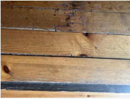
Sprekker i gulv.
