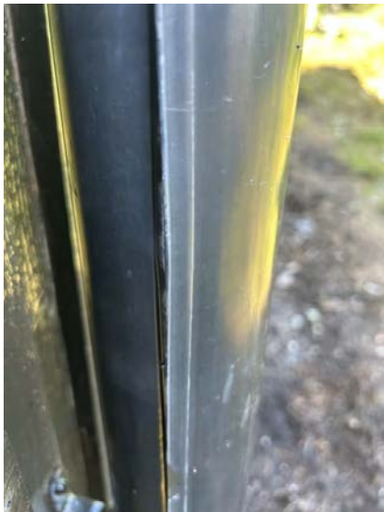
Frostspreg i nedløp.
