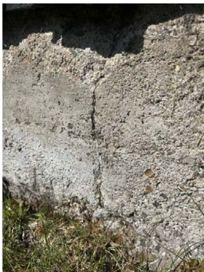
Sprekk i ringmur.
