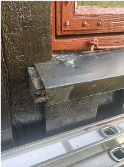
Utett mellom vannbrett og vindu.
