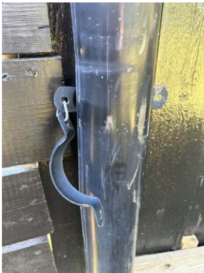
Manglende innfesting på nedløp.
