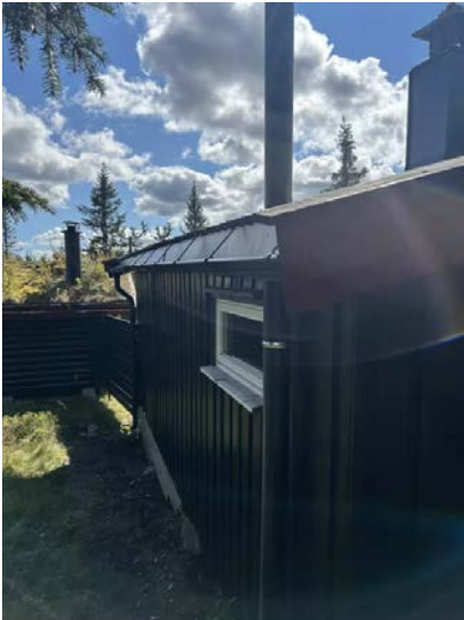
Ujevnheter i takrenne.
