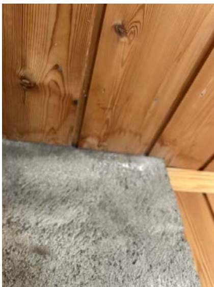
Fuktmerker i tak.
