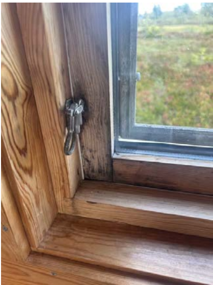
Fuktmerker og svertesopp i vinduskarm.
