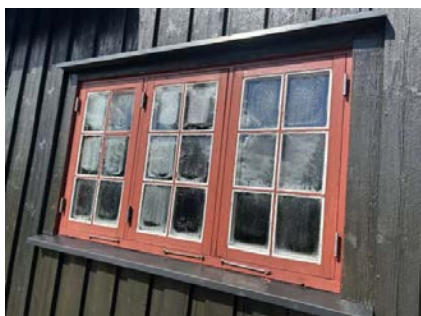
Dugg i mellom vinduer på stue.
