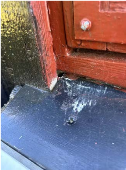
Utett mellom vannbrett og vindu.
