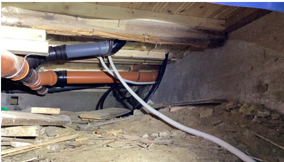
Det er observert råteskade på en sperre, flere skader kan finnes.
