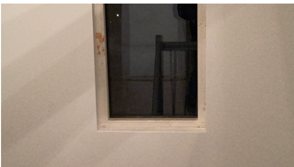
Eksempel på innvendig misfarging.
