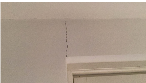
Eksempel på sprekk over dør.
