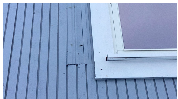
Det ser ut som det er benyttet innvendig panel snudd med baksiden ut ved siden av vindu i 2. etasje mot sør.
