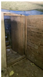
Dør til kjeller tetter ikke og har skader.
