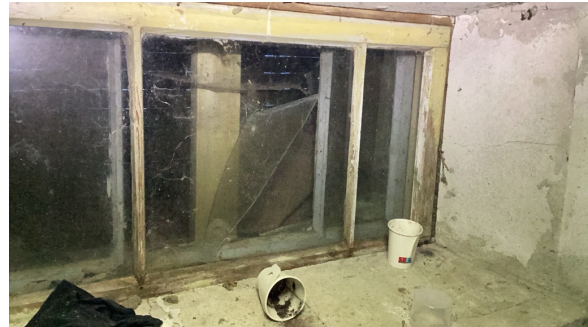
Kraftig slitasje på vindu i kjeller.
