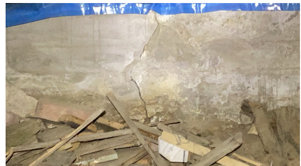
Eksempel på innvendig sprekk.
