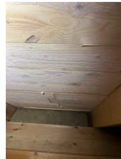
Det er frost flere steder på loft.
