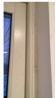
Rester etter lim/fugemasse på karm på verandadør.
