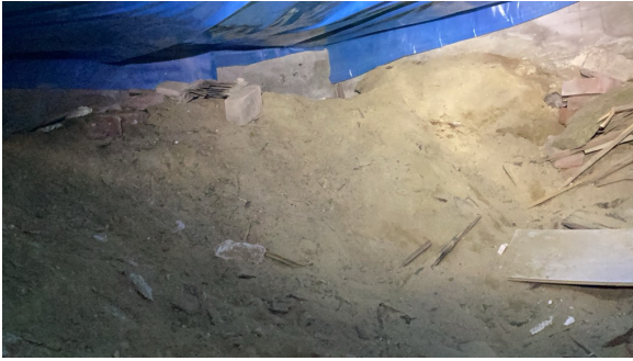
Det er ikke fuktsperre på bakken.
