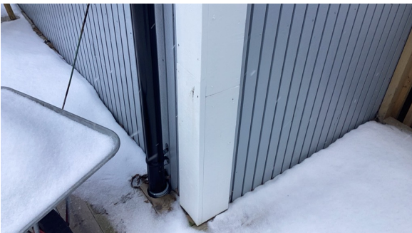
Hjørnekasser er skjøtet. Horisontale skjøter gir økt fare for fuktbelastning og utvikling av råte.
