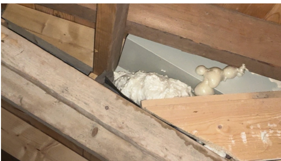
Det lyser stedvis inn ved takløft. Kun ettrinns tetting.
