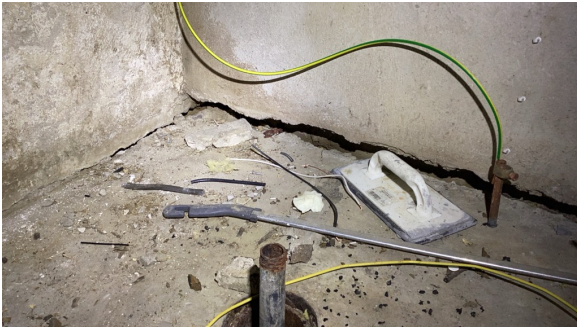
Det er sprekker mellom gulv og vegg.
