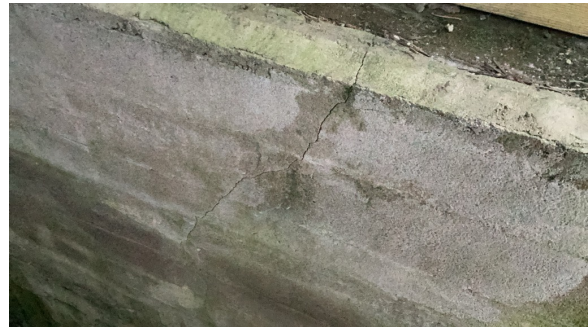
Flere sprekker i murer.
