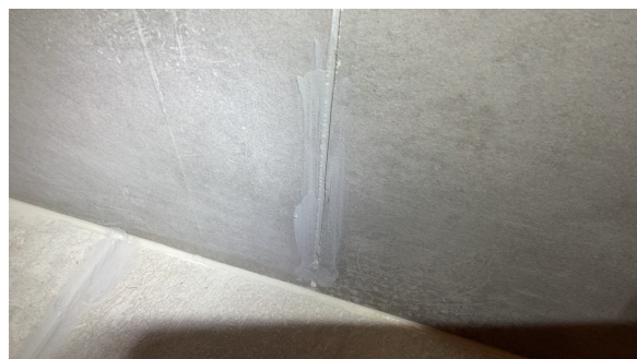
Eksempel på manglende rengjøring av fugemasse. Dette er flere steder.
