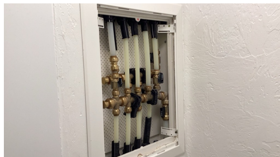
Fordelerskap for vannrør.
