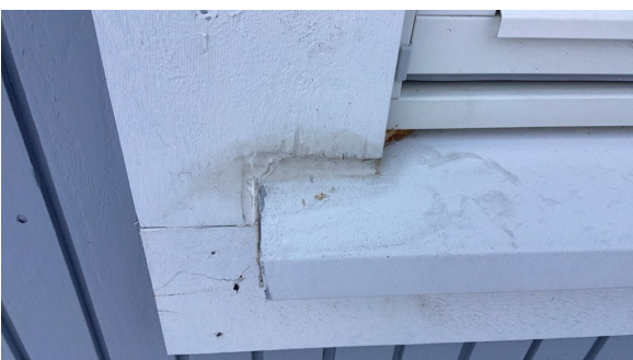
Stedvis fuget mellom vannbrett og omramming på vinduer.
