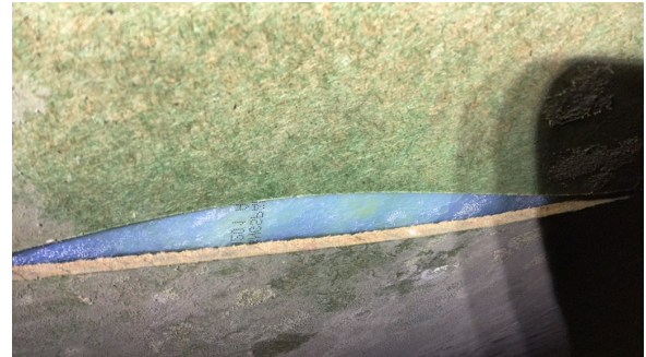
Plater i himling buler og det er kondens på oversiden av dampsperre flere steder.
