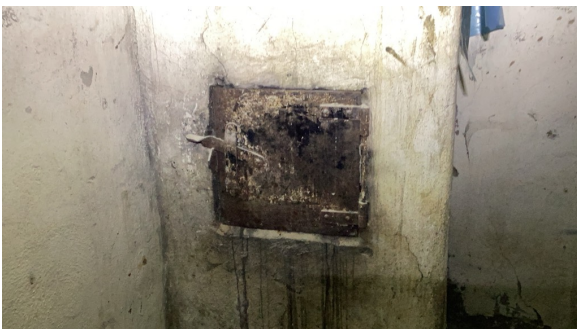
Sotluke i kjeller.
