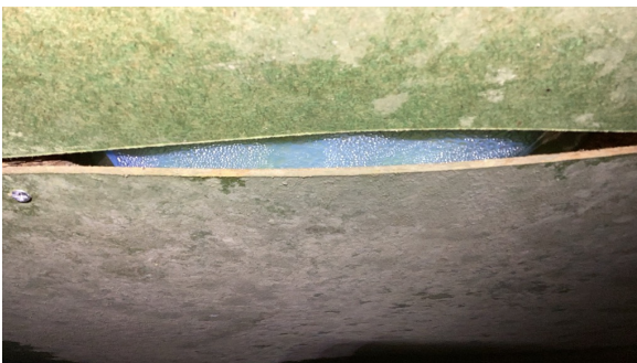
Plater i himling buler og det er kondens på oversiden av dampsperre flere steder.
