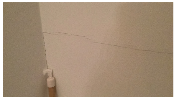
Eksempel på sprekk i veggflate.
