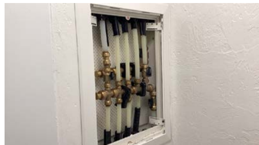
Fordelerskap for vannrør.
