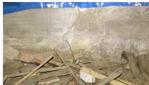
Eksempel på innvendig sprekk.
