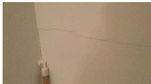
Eksempel på sprekk i veggflate.
