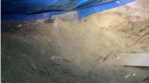
Det er ikke fuktsperre på bakken.
