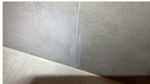
Eksempel på manglende rengjøring av fugemasse. Dette er flere steder.
