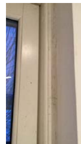
Rester etter lim/fugemasse på karm på verandadør.
