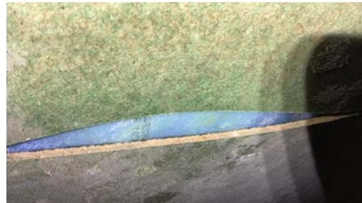
Plater i himling buler og det er kondens på oversiden av dampspærre flere steder.
