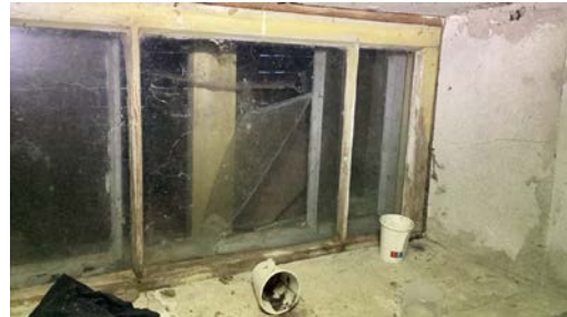
Kraftig slitasje på vindu i kjeller.
