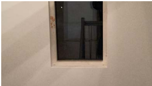
Eksempel på innvendig misfarging.
