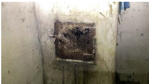
Sotluke i kjeller.
