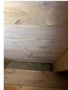
Det er frost flere steder på loft.
