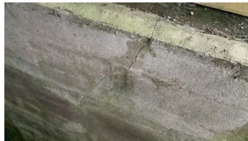
Flere sprekker i murer.
