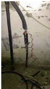
Vanninntak med stoppekran i kjeller, er senere kasset inn
