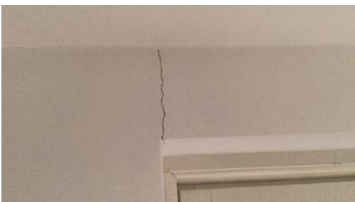
Eksempel på sprekk over dør.
