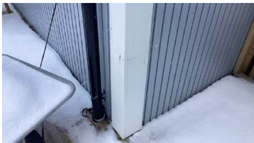
Hjørnekasser er skjøtet. Horisontale skjøter girt økt fare for fuktbelastning og utvikling av råte.
