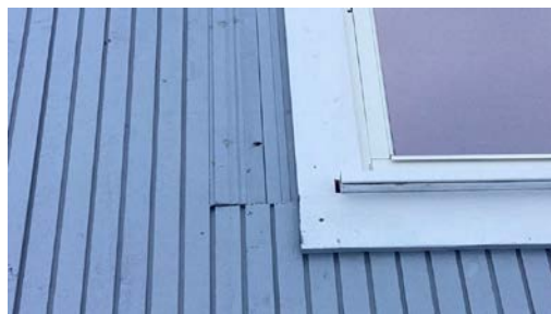
Det ser ut som det er benyttet innvendig panel snudd med baksiden ut ved siden av vindu i 2. etasje mot sør.
