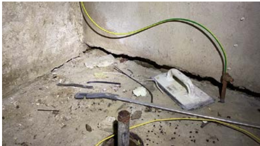
Det er sprekker mellom gulv og vegg.
